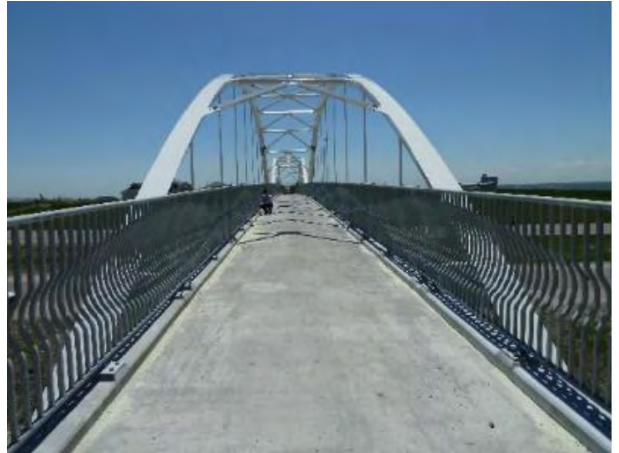
Arbour Stone Rise, AB – CSA S7 Annex B
